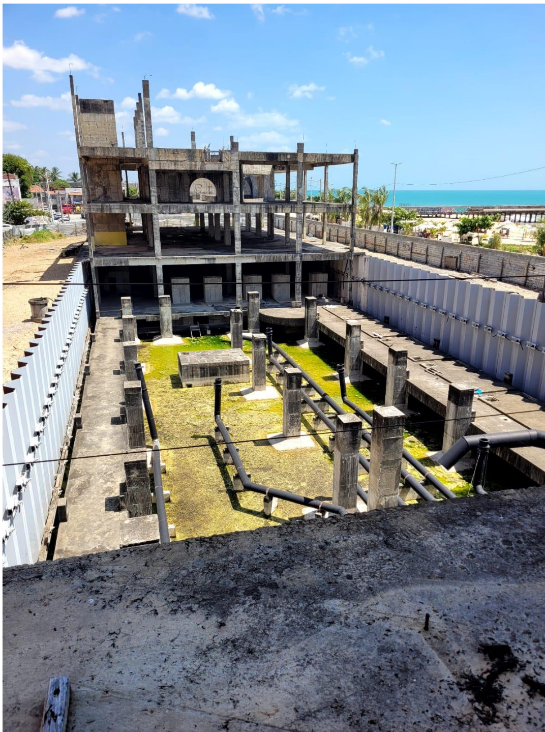
FOTO 34 – EXECUÇÃO DE NOVAS LAJES NO TETO DO PAV. TÉRREO, 1º. PAVIMENTO, 2º. PAVIMENTO E 3º. PAVIMENTO
