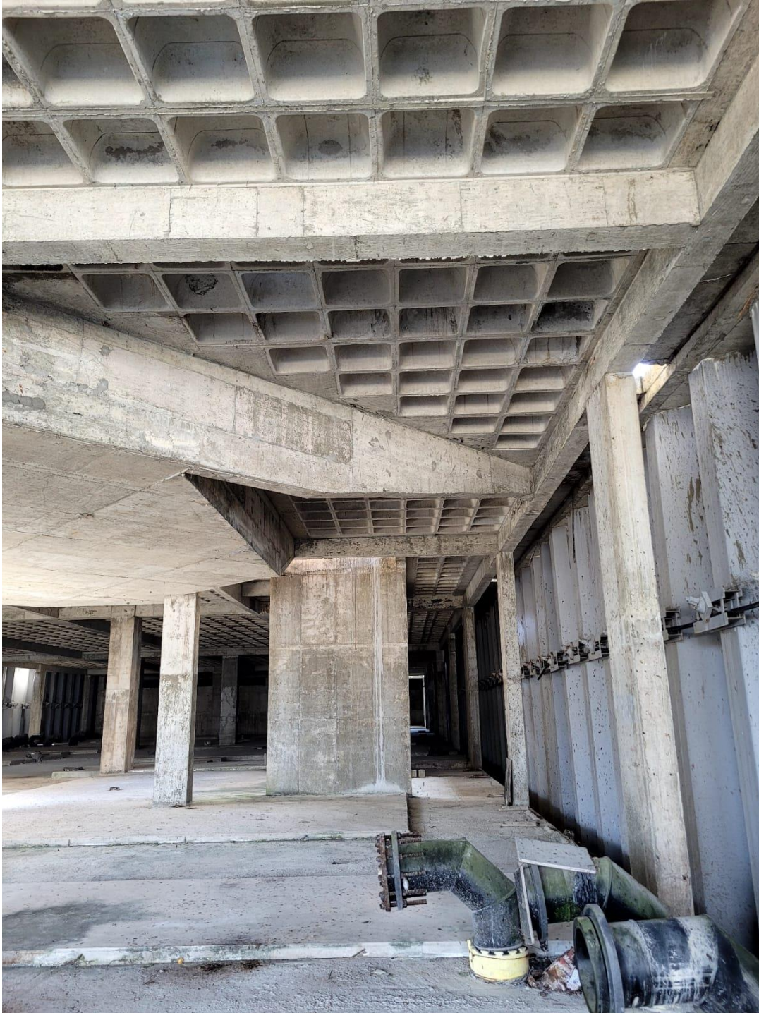
FOTO 23 – VERIFICAR REDUÇÃO DE VIGA E COLOCAR LAJE FLUTUANTE PARA FECHAMENTO DO AQUÁRIO
