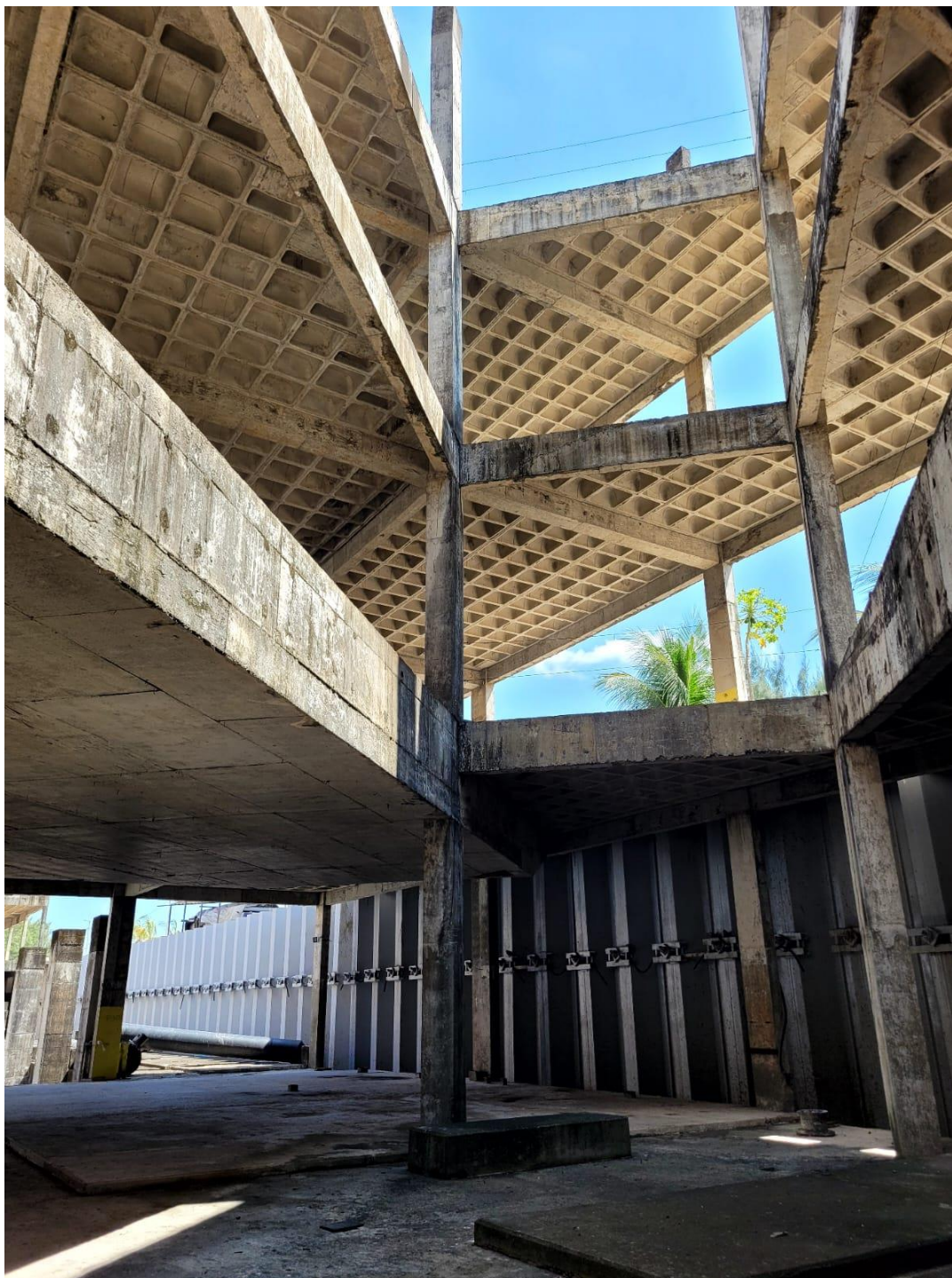
FOTO 25 – FECHAMENTO DAS LAJES DE TETO DO PAV. TÉRREO – 1º. PAVIMENTO E 2º. PAVIMENTO
