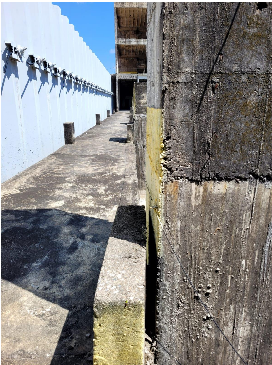
FOTO 13 – JUNTAS ENTRE PILARES QUE TERÃO A FUNÇÃO DE APOIO DOS PISOS ACIMA DO AUDITÓRIO
