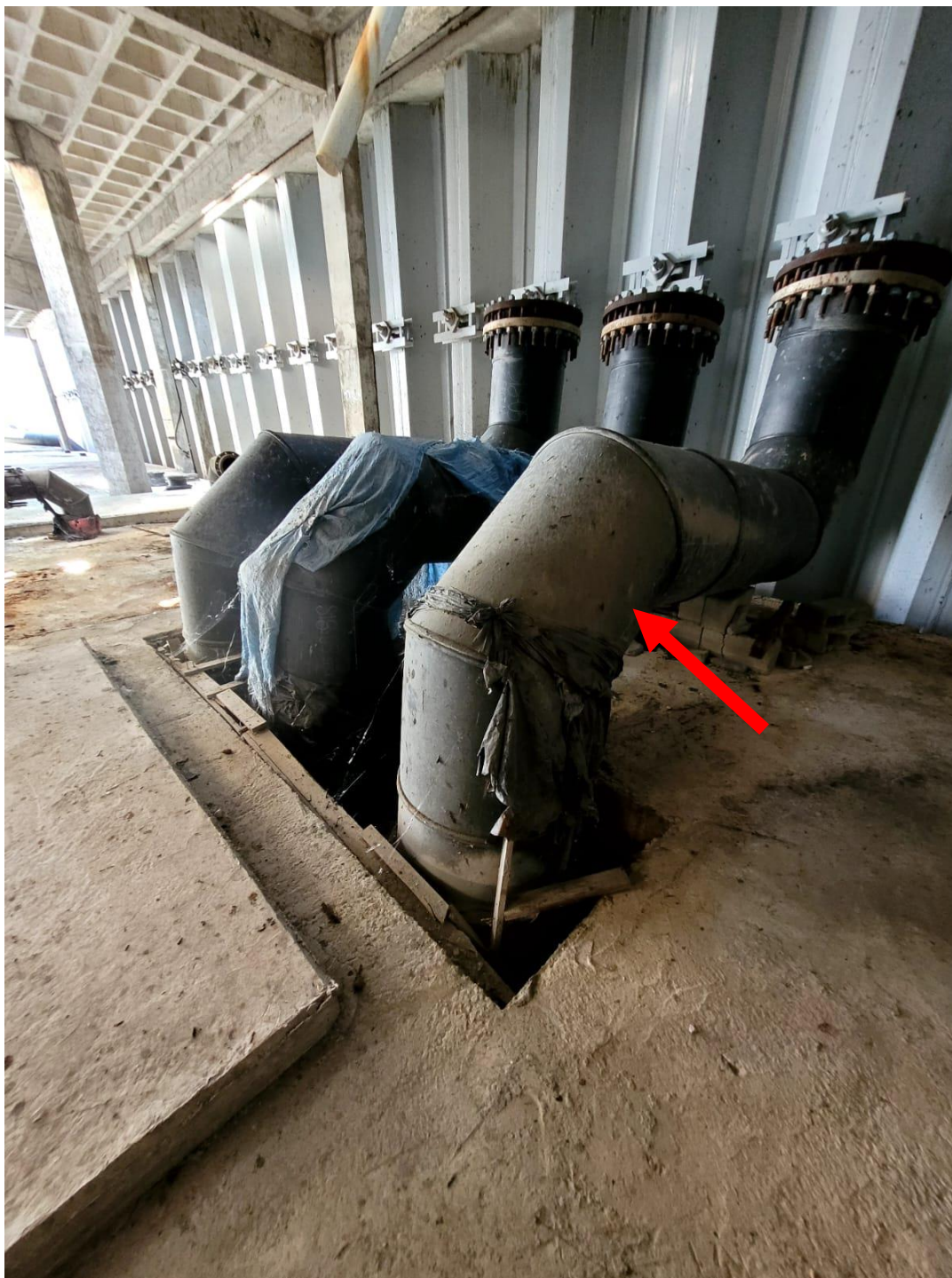
FOTO 10 – TUBULAÇÕES NO TETO DO PAV. TÉCNICO QUE SERÃO RETIRADAS E ABERTURAS FECHADAS COM LAJE MACIÇA: H=14
