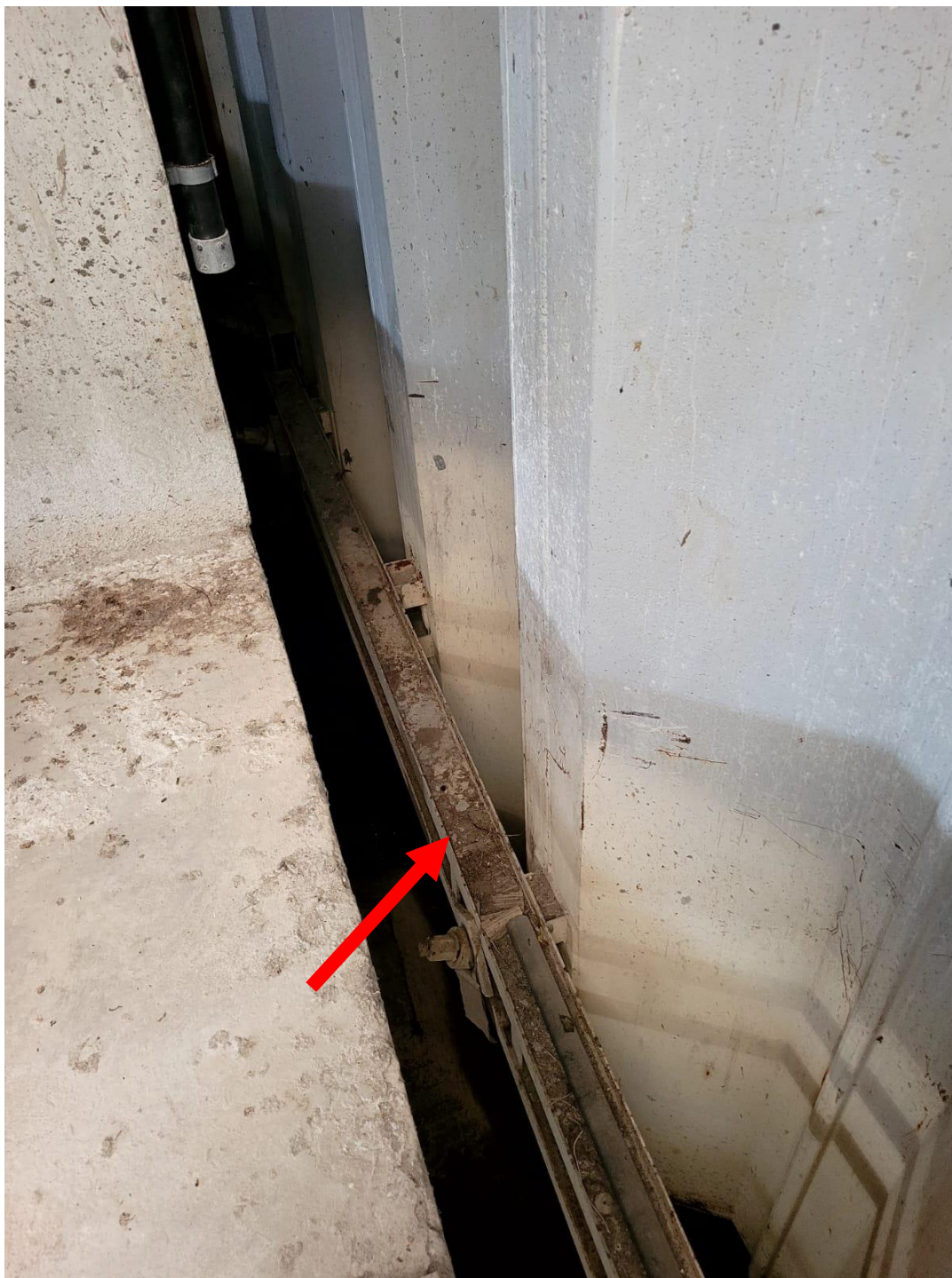
FOTO 18 – CONTENÇÃO COM ALGUNS PONTOS DE CORROSÃO
