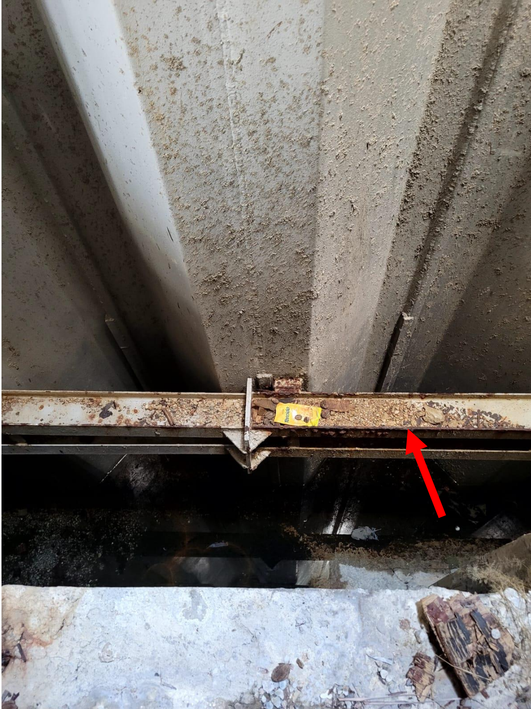
FOTO 28 – CONTENÇÃO COM CORROSÕES PONTUAIS
