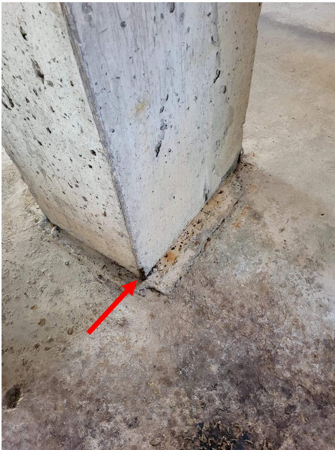
FOTO 21 – CORROSÃO DE ARMADURAS NA BASE DO PILAR - TRECHOS PONTUAIS
