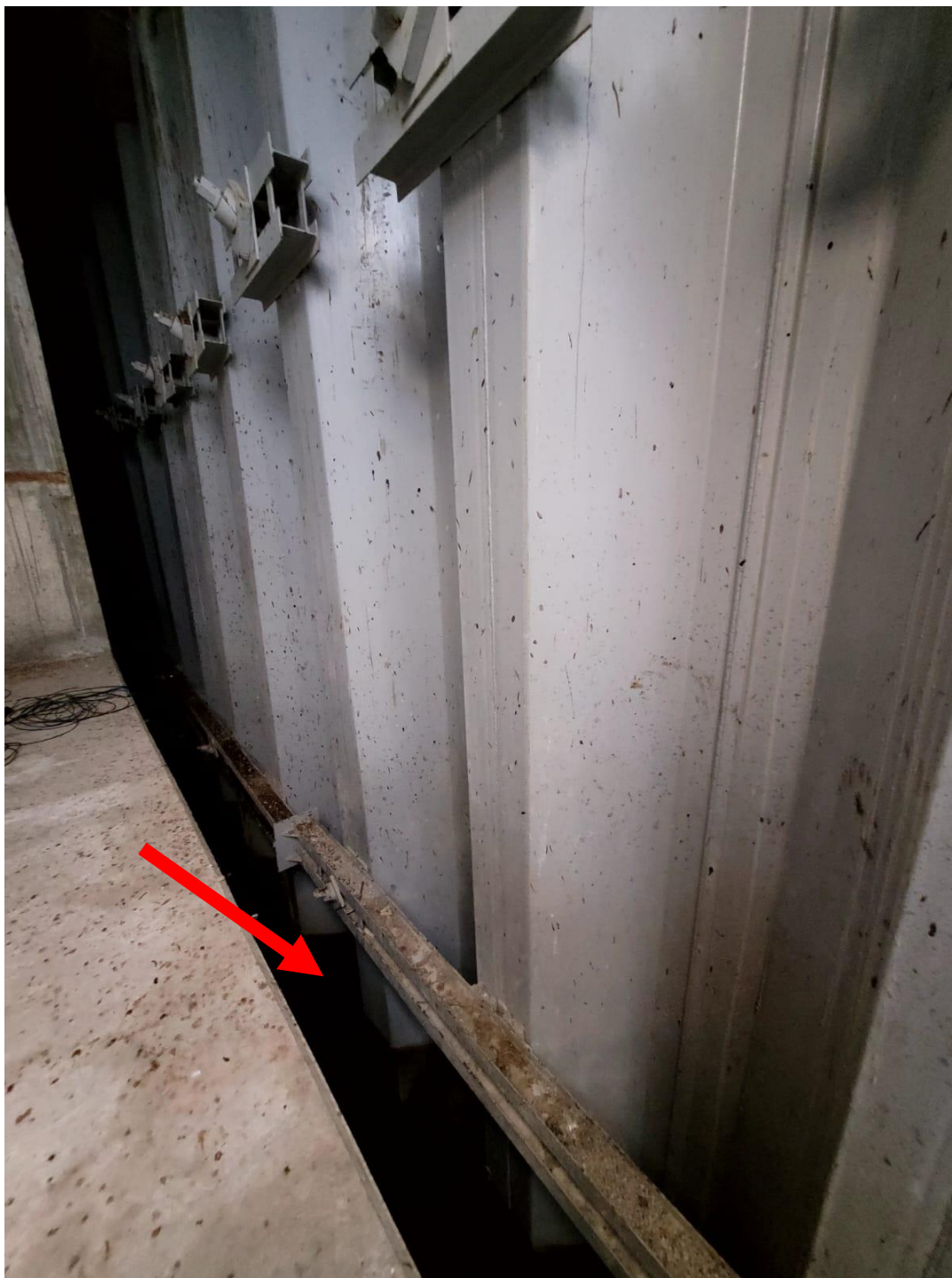
FOTO 04 – CONTENÇÃO METÁLICA AFASTADA DA ESTRUTURA E TRECHOS PONTUAIS DE CORROSÃO NO SUBSOLO
