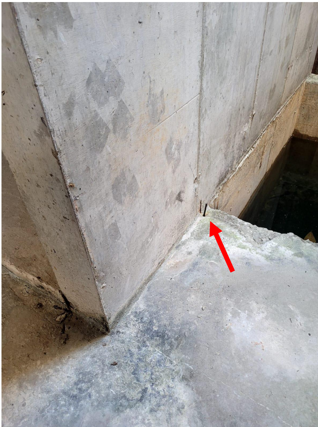
FOTO 19 – CORROSÃO DE ARMADURAS NA BASE DO PILAR - TRECHOS PONTUAIS
