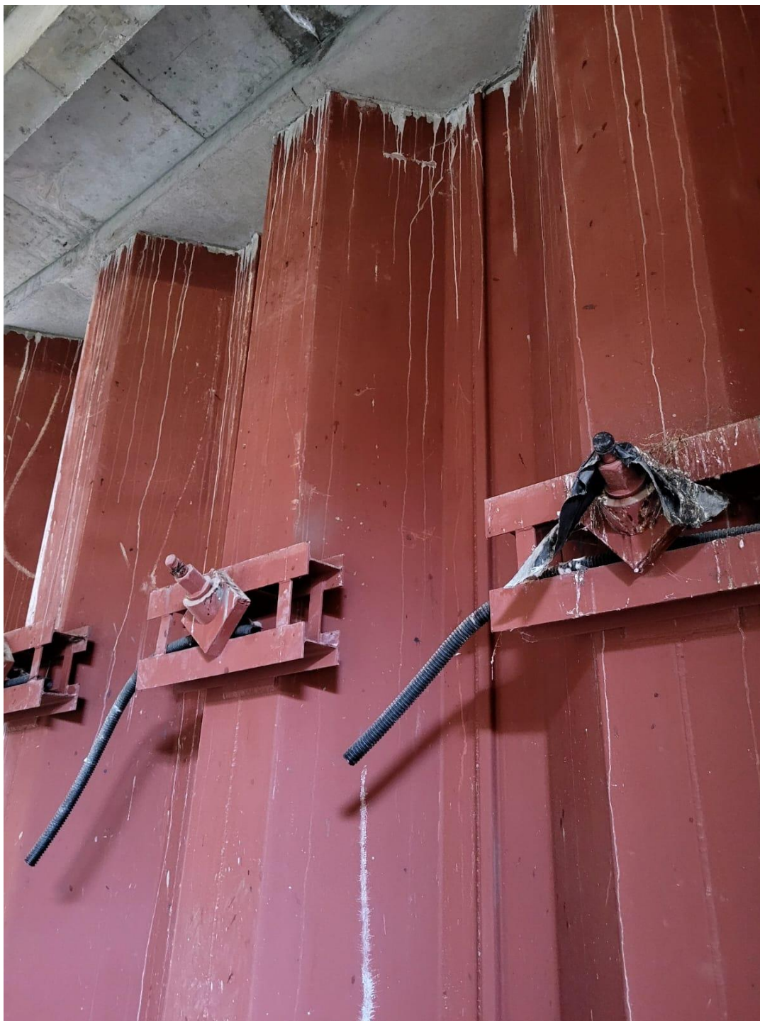
FOTO 16 – VERIFICAR A PROTEÇÃO CATÓDICA DA CONTENÇÃO
