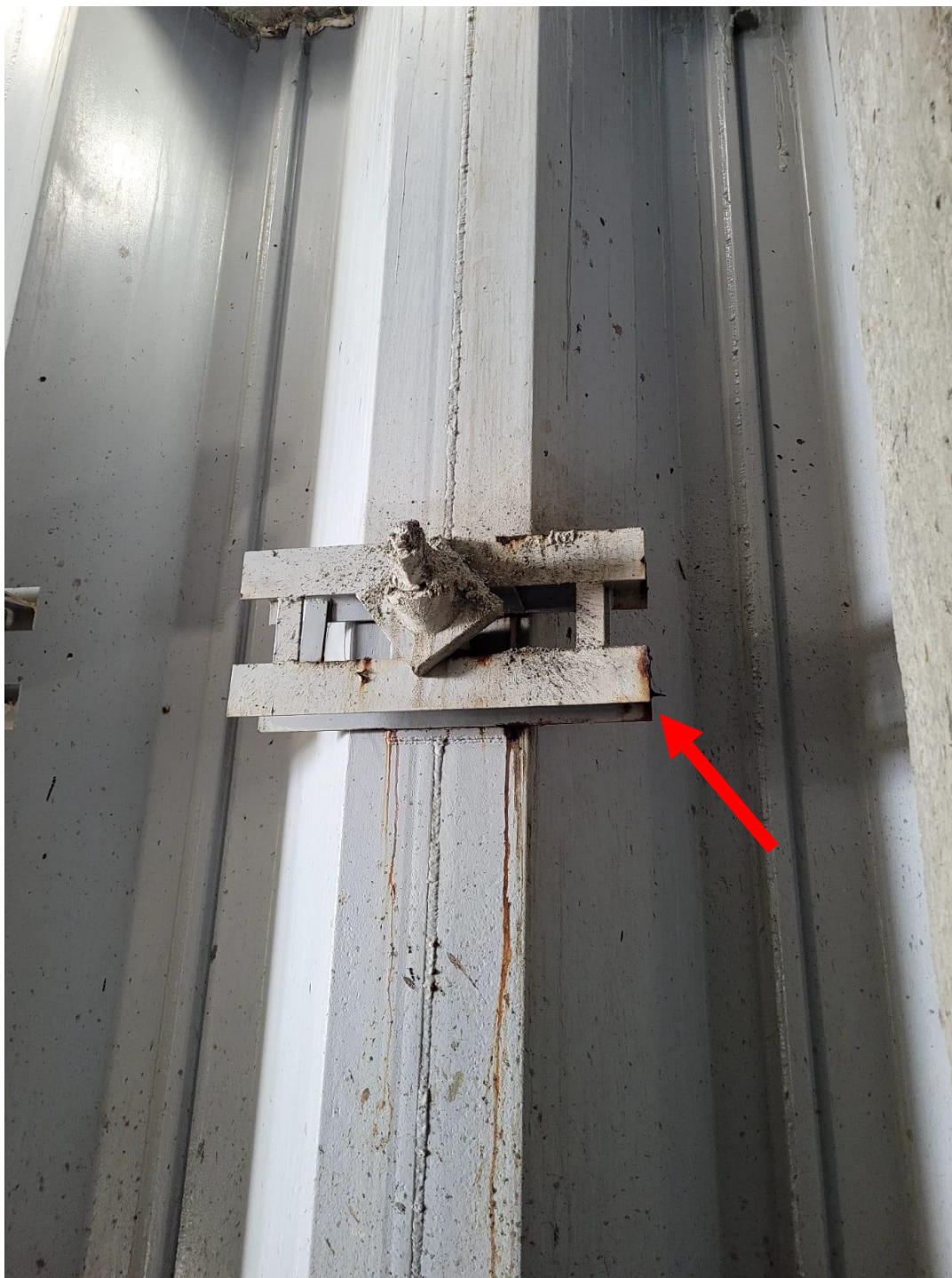
FOTO 26 – CONTENÇÃO COM CORROSÕES PONTUAIS
