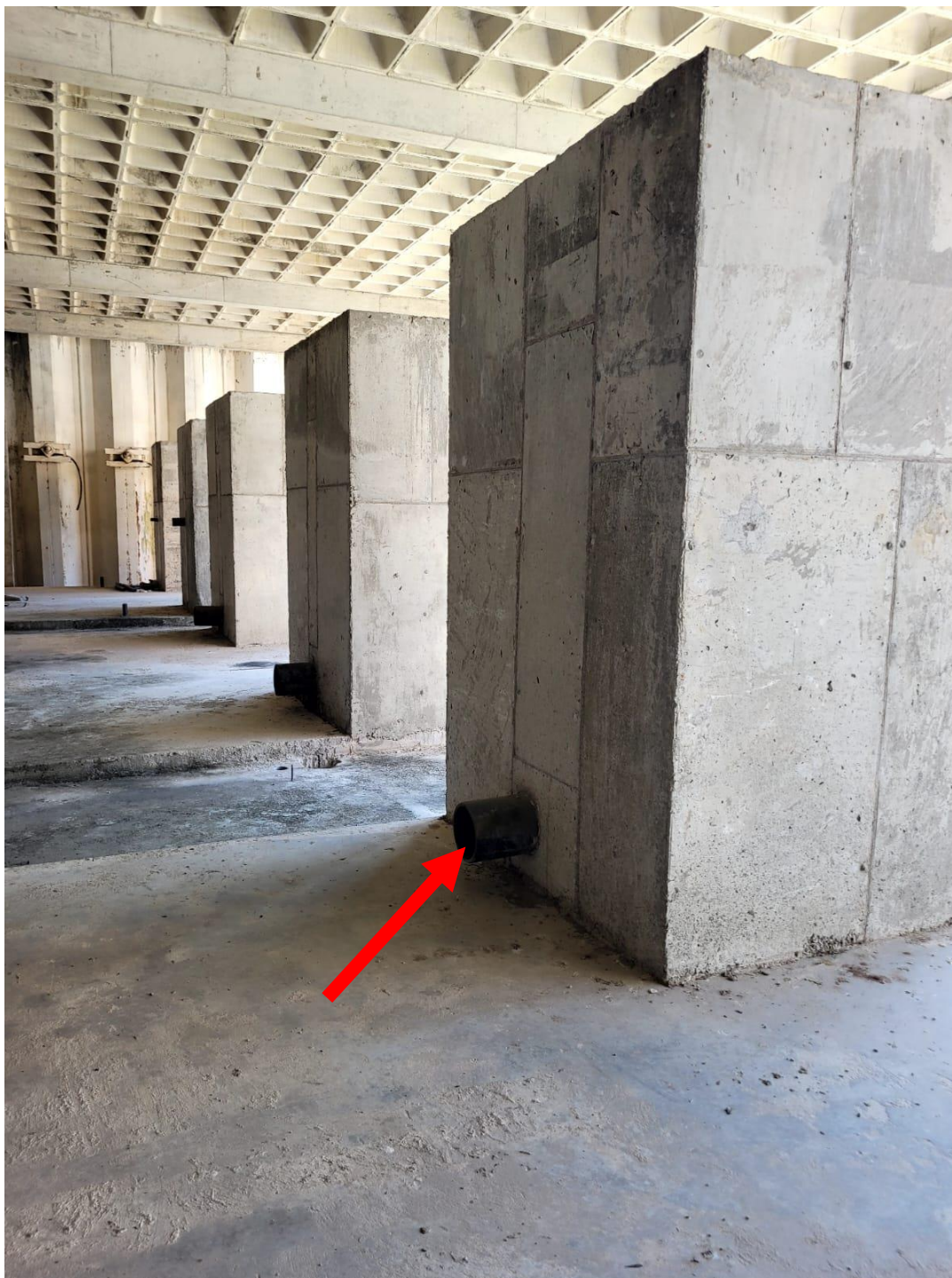
FOTO 14 – CAIXAS DE CONCRETO E BASES QUE SERÃO RETIRADAS E APOIADAS SOBRE LAJE DE TETO DO PAV. TÉCNICO
