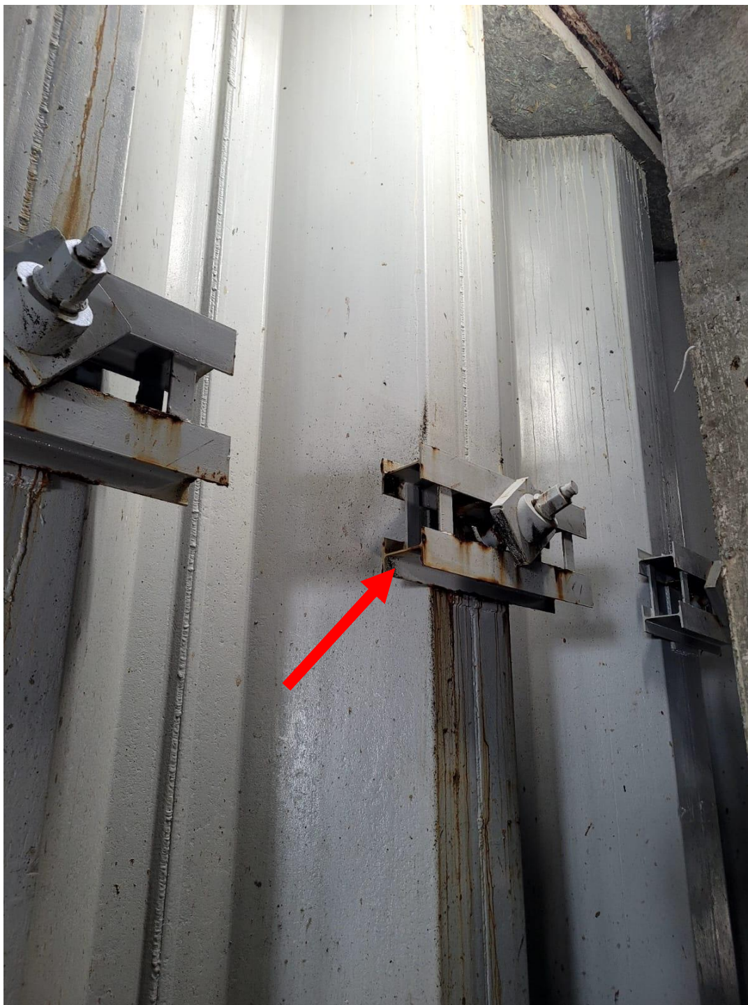
FOTO 27 – CONTENÇÃO COM CORROSÕES PONTUAIS
