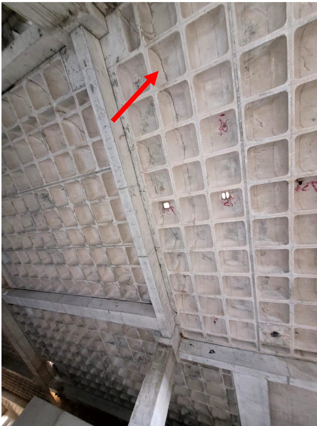
FOTO 05 – FISSURAS NO TETO DO SUBSOLO A SEREM COLMATADAS
