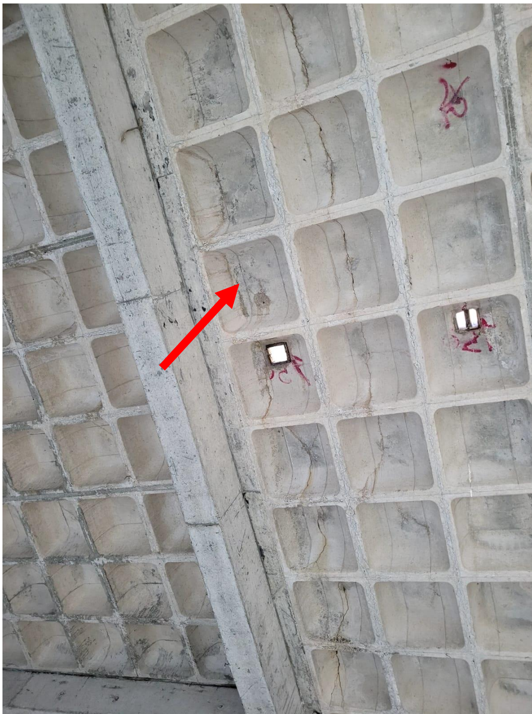
FOTO 06 – FISSURAS NO TETO DO SUBSOLO A SEREM COLMATADAS
