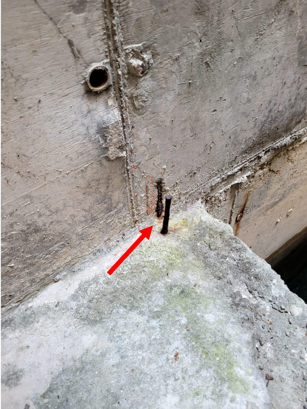
FOTO 20 – CORROSÃO DE ARMADURAS NA BASE DO PILAR - TRECHOS PONTUAIS
