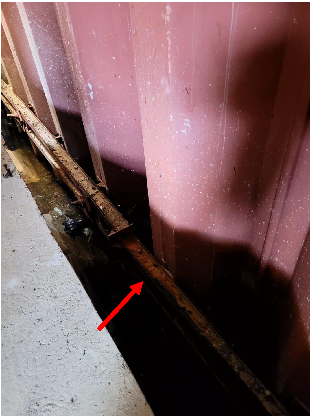
FOTO 17 – CONTENÇÃO COM ALGUNS PONTOS DE CORROSÃO
