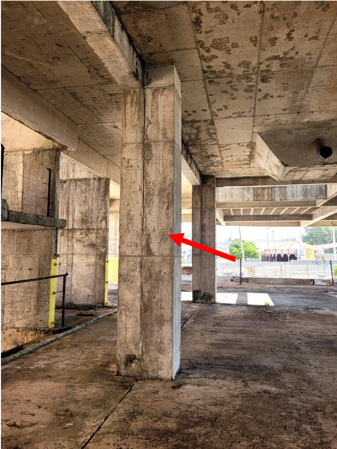
FOTO 53 – PROLONGAMENTO DOS PILARES DO TÚNEL DO AQUÁRIO PARA A NOVA LAJE DE TETO DO 2º. PAVIMENTO
