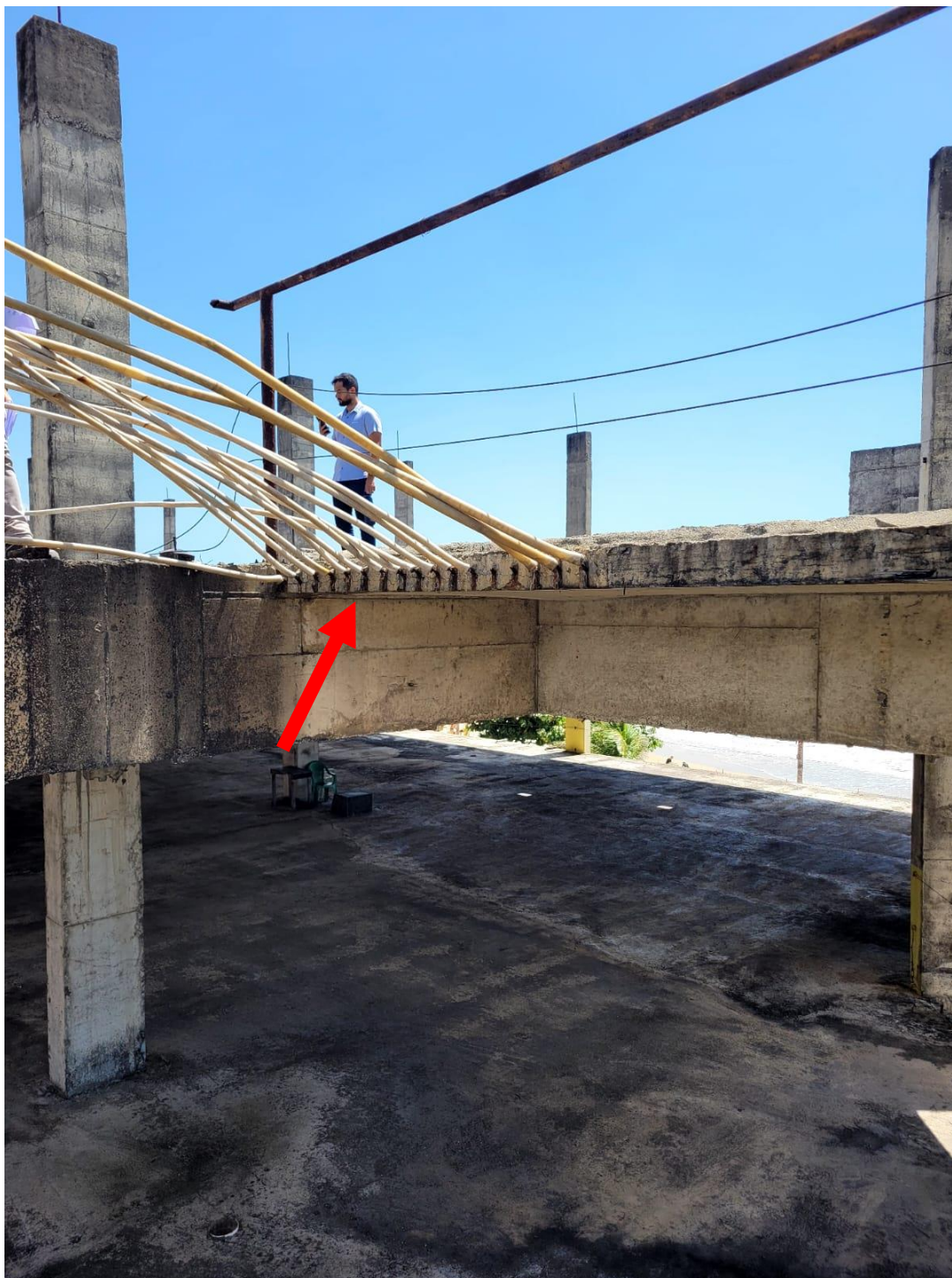
FOTO 36 – ARMADURA DE ESPERA DA ESCADA PARA O ACESSO DO NOVO TETO DO 3º. PAVIMENTO
