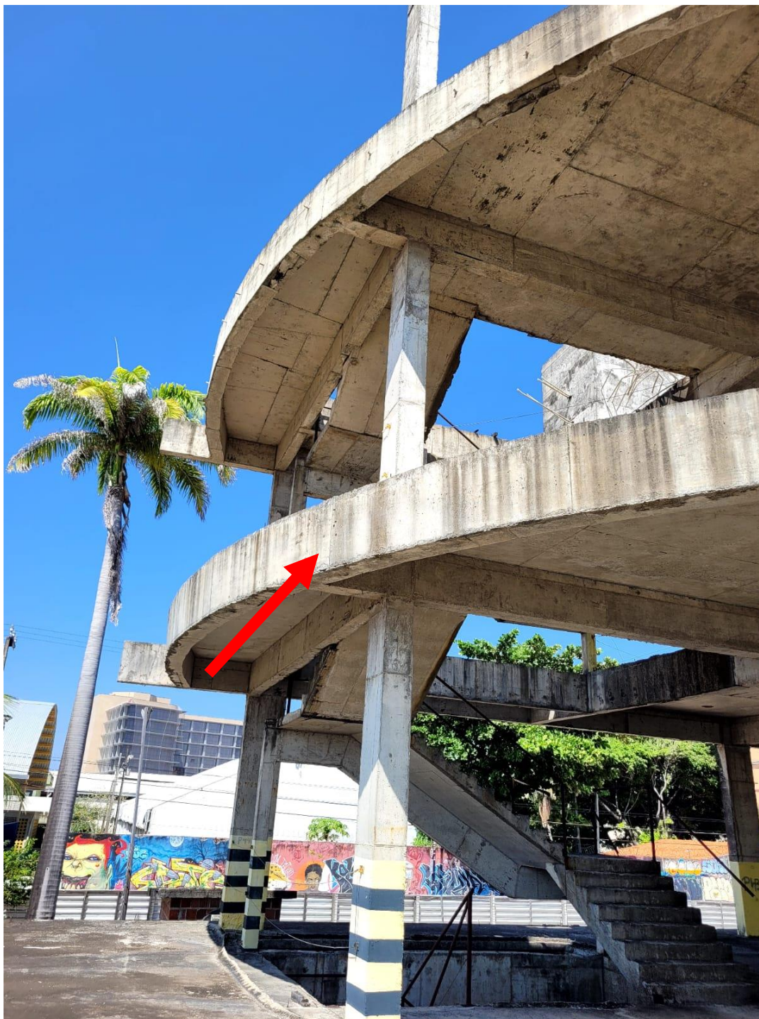
FOTO 02 – NECESSIDADE DE LAVAGEM DO CONCRETO EXTERNO
